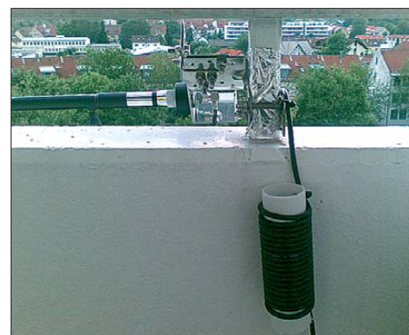
Bild 4: Mantelwellensperre nahe am Fußpunkt aus 20 Windungen Koaxialkabel
